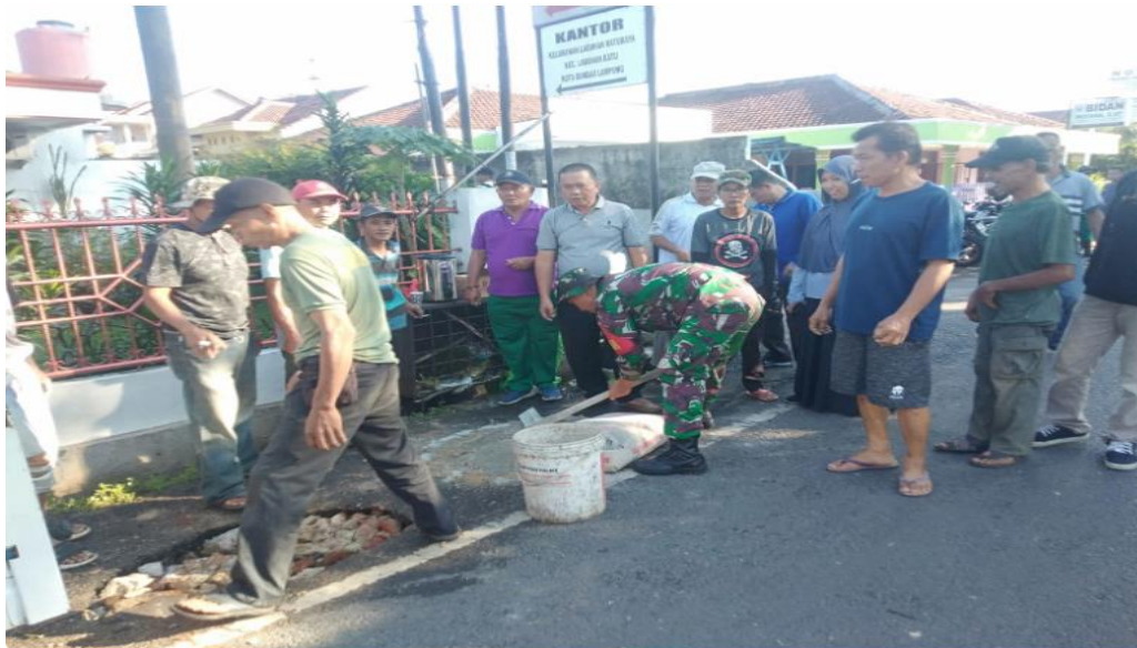
Bandar Lampung (LM) : Warga Kelurahan Labuhan Ratu Raya Bandar Lampung bergotong royong pada Jum'at (14/6/2024), membersihkan jalan dan Parit yang tersumbat karena banyak nya sampah dan menutup lobang PDAM yang sangat dalam
